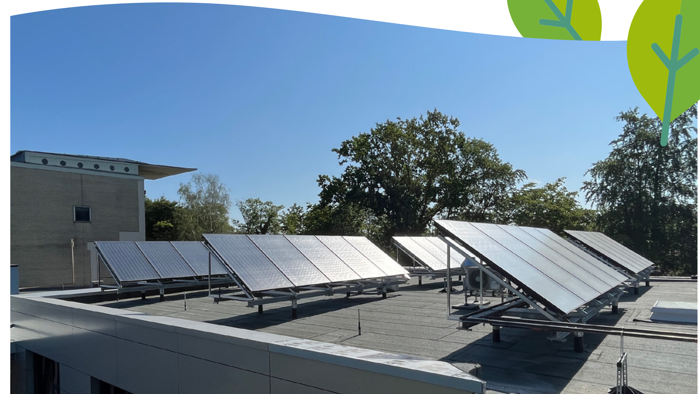
Entsprechend den statischen Möglichkeiten haben wir auf einigen Dächern Solarpanels zur Unterstützung der Warmwasserbereitung installiert.
